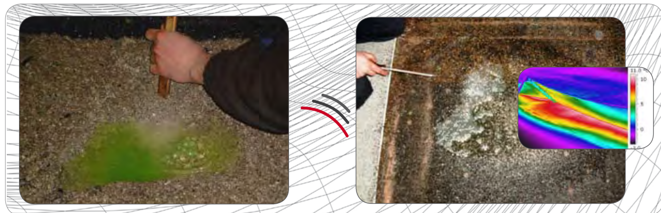
STADION KLESSHEIM Rasenheizung undicht
