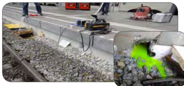
HAUPTBAHNHOF SALZBURG Undichtigkeit gefunden mittels Färbemittel
